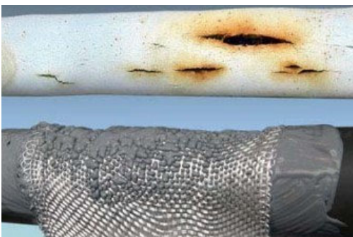
ترمیم کابل‌های آسیب‌دیده، ترک خورده یا پوسیده
